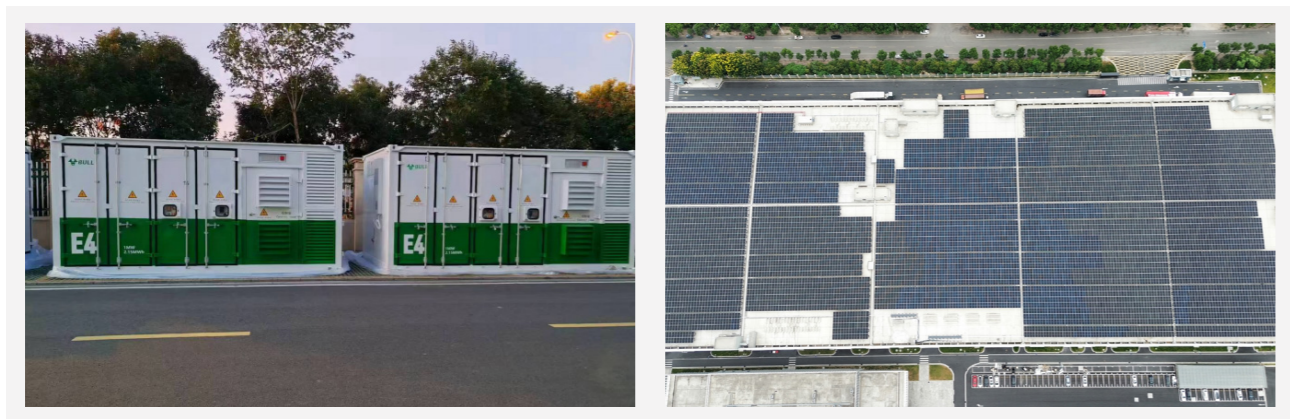
▲ 龙山二基地电力储能设施
